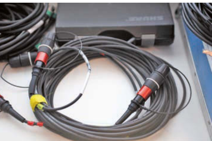
Glasfaserkabel – bei der stetig wachsenden Datenmenge in Audionetzwerken nicht mehr wegzudenken
