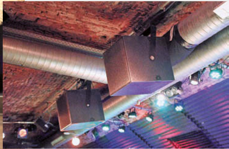
Bild 4: Zwei der vier altgedienten d&b C7-Tops hängen an der Deckenmitte, um den Raum zwischen einer Säule im Publikumsbereich „hindurch“ zu beschallen
